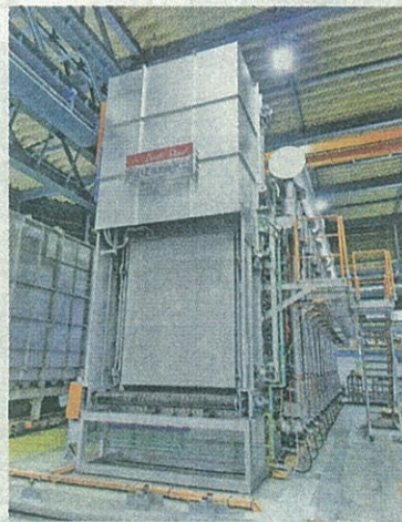
増設した大同特殊鋼製STC炉
